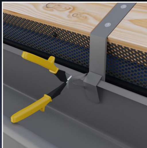
Tworzymy punkt stały dylatacji poprzez nacięcie tylnego usztywnienia rynny po obu stronach najbardziej środkowego haka używając lewych i prawych nożyc. Punkt stały środkowego haka powoduje skrócenie dylatacji o połowę.
